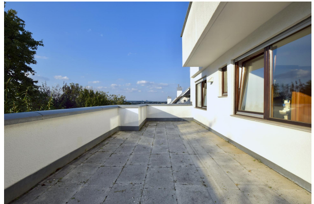
Balkon / Dachterasse im 1. OG
