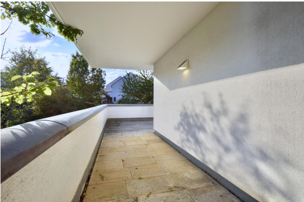
Balkon / Dachterasse im 1. OG
