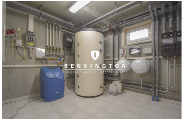
KSW238-Einfamilienhaus in Essingen-Heizraum
