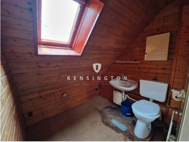
WC auf dem Dachboden
