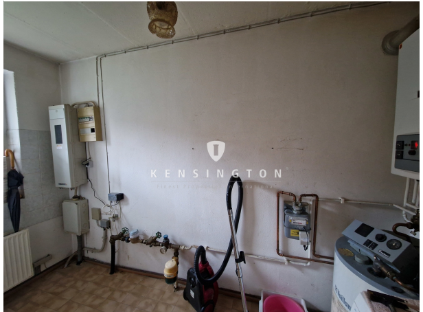
Haus- und Technikraum
