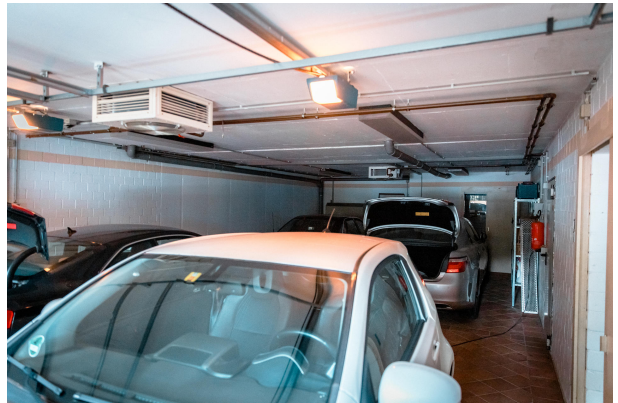
tiefe Garagen mit elektrischen Tooren
