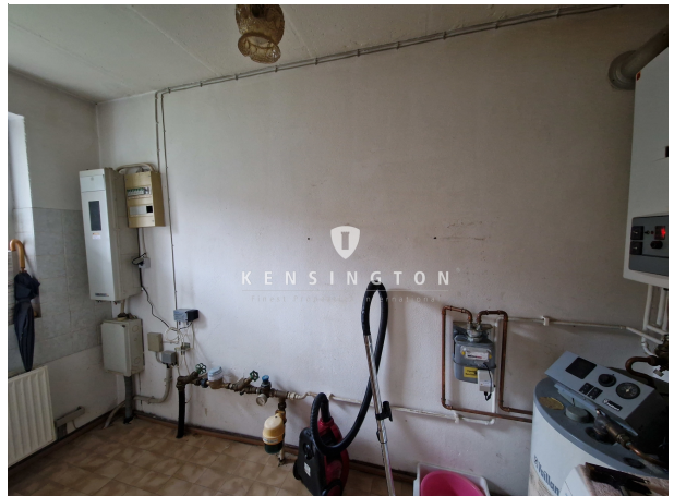
Haus- und Technikraum
