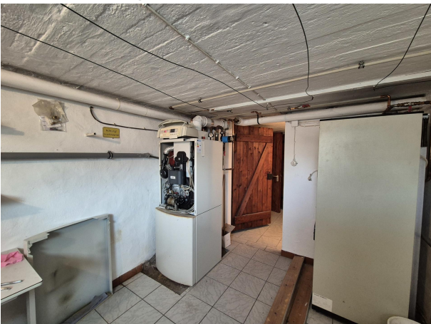
Keller mit Heizung
