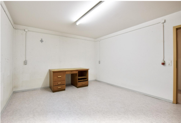
Beheizter Kellerraum / Werkstatt
