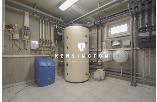
KSW238-Einfamilienhaus in Essingen-Heizraum
