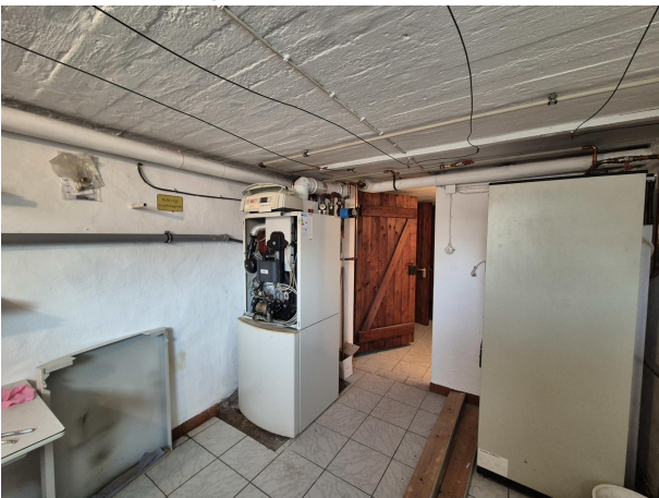
Keller mit Heizung
