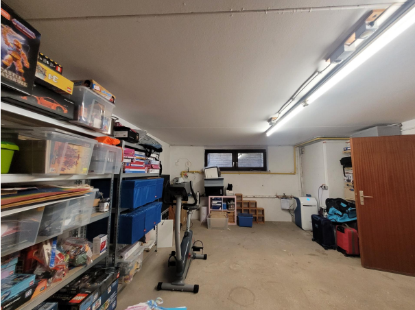
Keller mit Heizung
